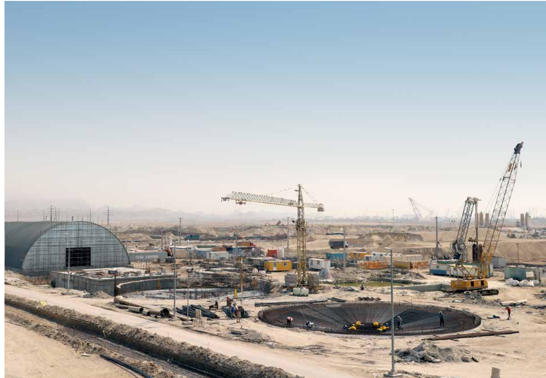
Водоопреснительная станция на 200000 м 3 в Бандар-Аббасе
